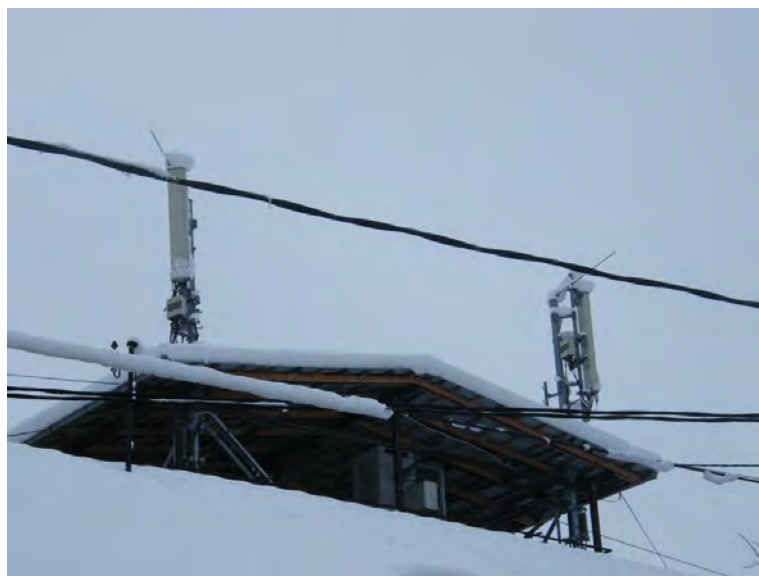
Slika 2.2.a. Fotografija predmetnog antenskog sistema i bazne stanice operatera Telekom Srbija
