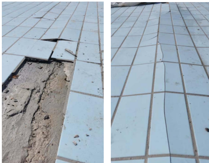
Слика 2. Оштећења плочица и армирано бетонске плоче базена
