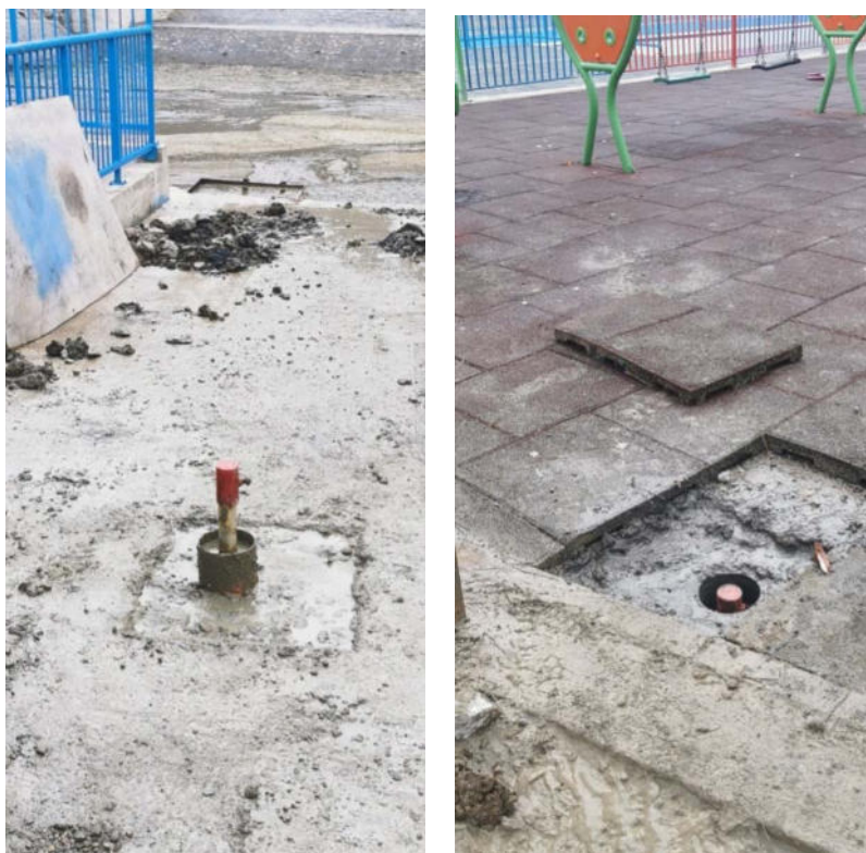
Слика 4. Пијезометарске конструкције Р-1 (лево) и Р-2 (десно) након уградње и заштите
