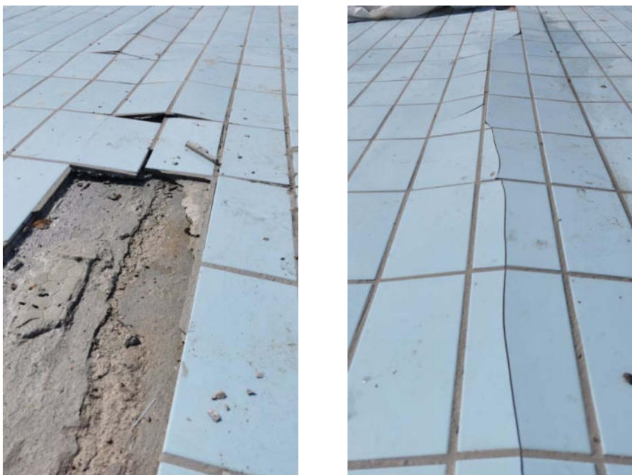
Слика 2. Оштећења плочица и армиранобетонске плоче базена
